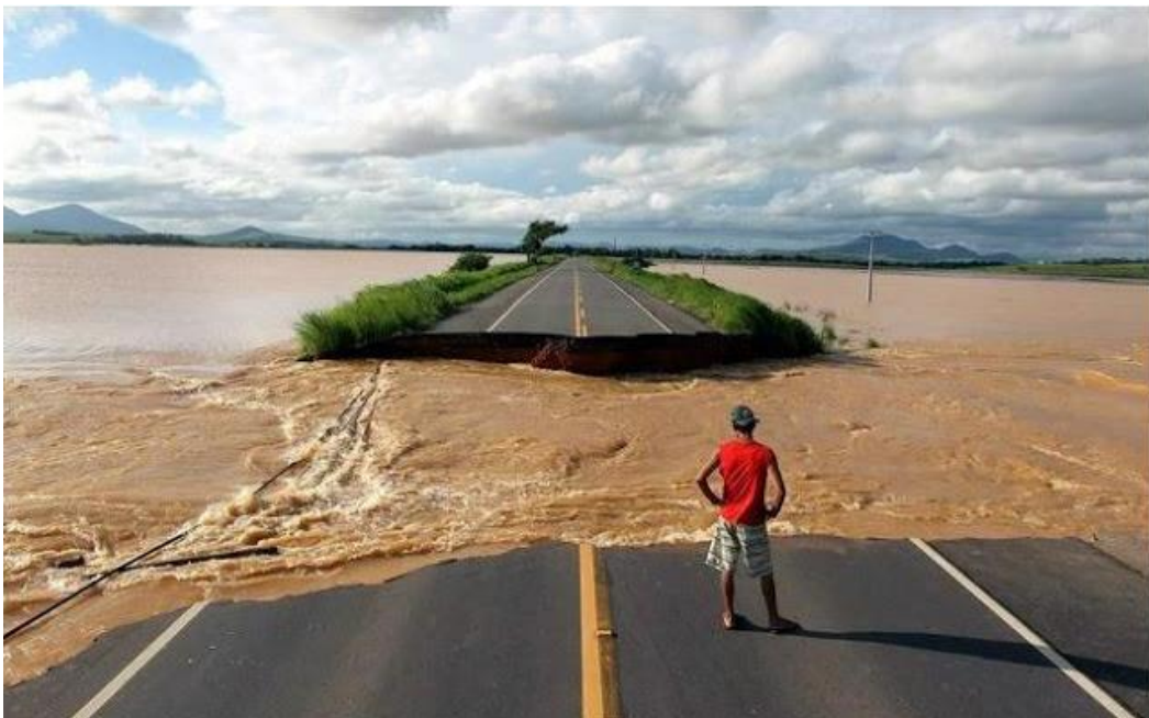
Figura 11 - Ruptura da BR-356.
