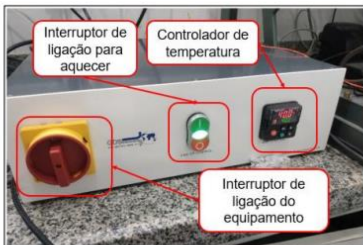
Figura 21 — Sistema de controle de temperatura do laboratório da centrifuga geotécnica – UENF
