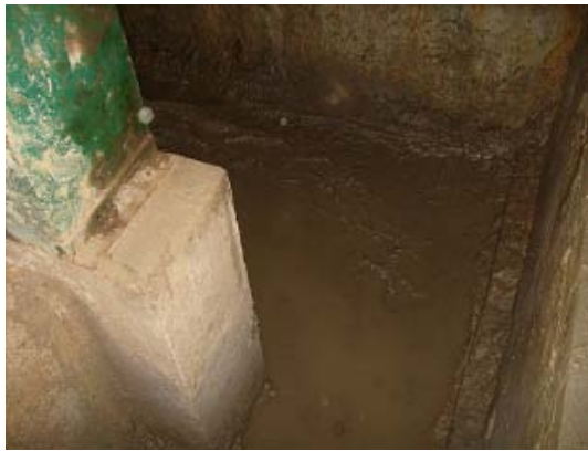
Figura 29 - Alagamento da área dos caixões dosadores
