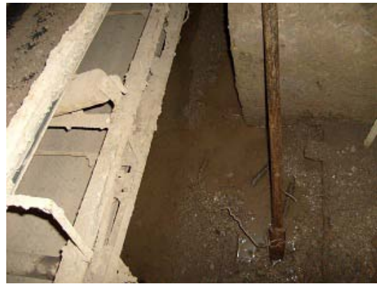
Figura 30 - Alagamento da área dos caixões dosadores
