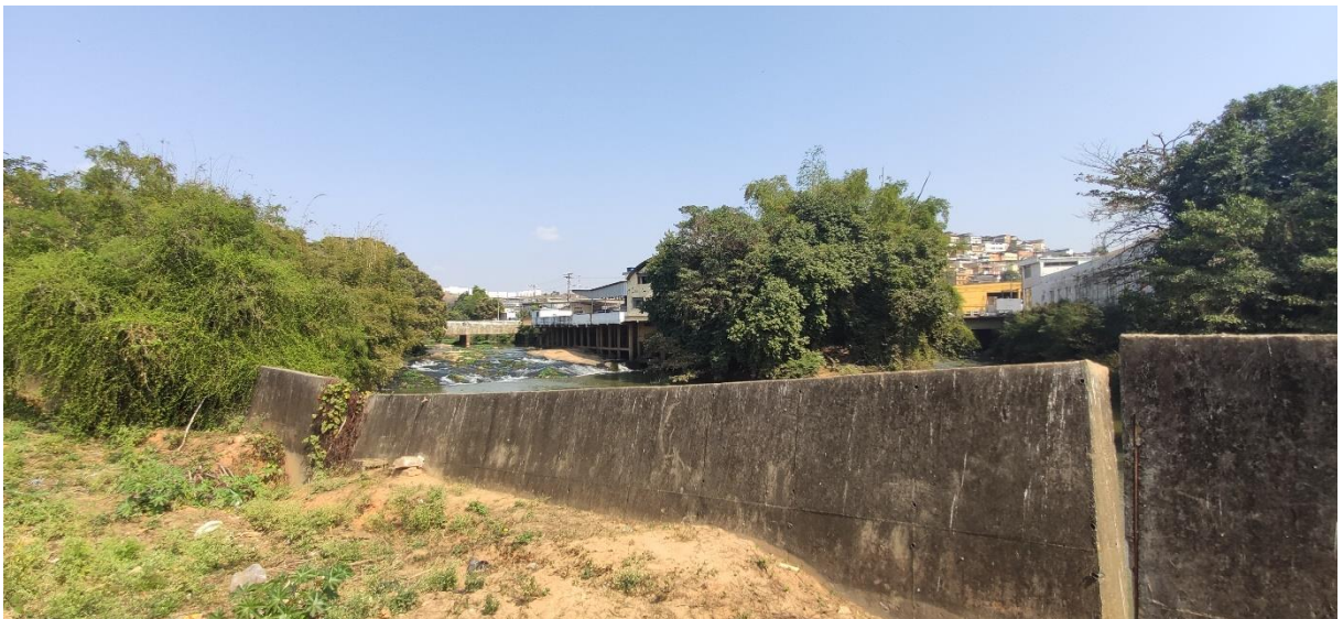
Figura 10: Muro de contenção de enchentes, construído no entorno do Rio Muriaé na região da Prainha no bairro da Barra em Muriaé-MG.
