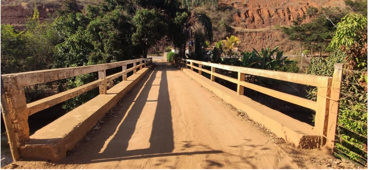
Figura 6: Ponte sob o Rio Muriaé, na BR 265 que liga Muriaé-MG a Mirai-MG, evidenciando erosão das encostas.
