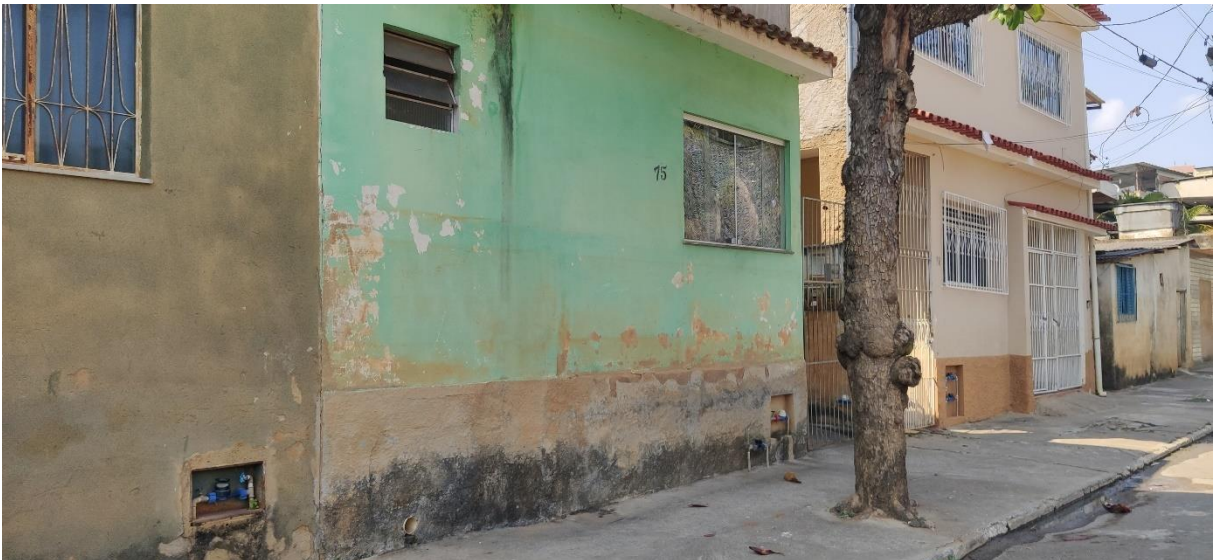
Figura 12: Marcas de enchente nas casas da região da Prainha no bairro da Barra em Muriaé-MG. Fonte: Fotografia do próprio autor, 2021.
