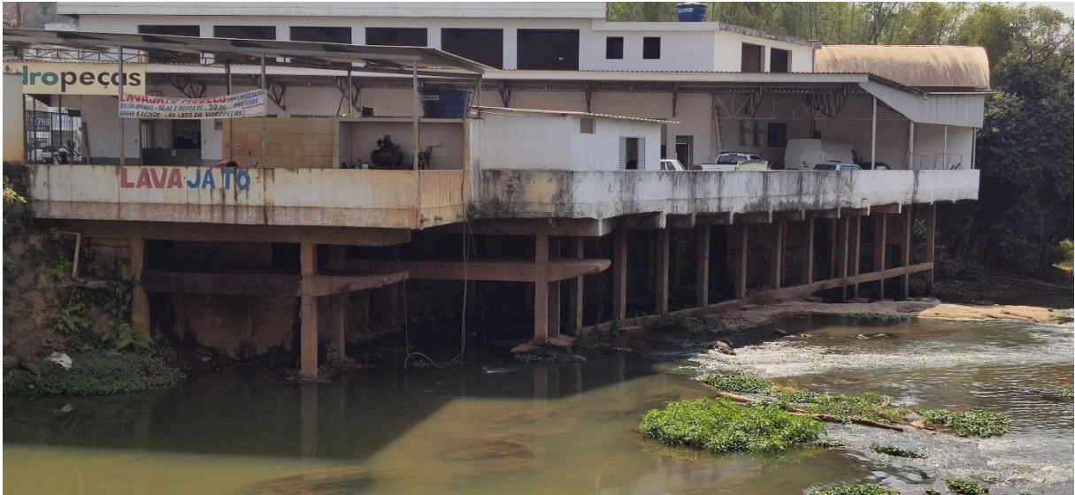
Figura 17: Fotografia realizada em cima da ponte do bairro da Barra em Muriaé-MG, evidenciando o uso da água do rio para lavagens de automóveis e descarte de efluentes deste processo nos cursos d'água.
