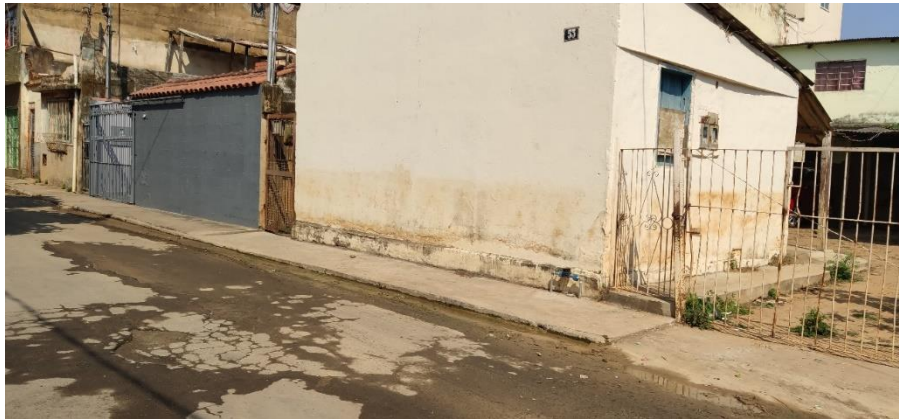
Fotografia realizada na região da Prainha em 12 de agosto de 2021 evidenciando marcas de enchentes nas paredes das casas.
