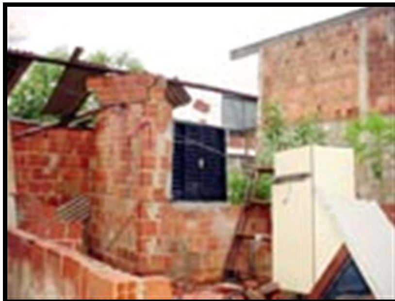
Foto 49: Desabamento de casa em Três Vendas em dezembro de 2004 (Fonte: Jornal "Monitor Campista").
