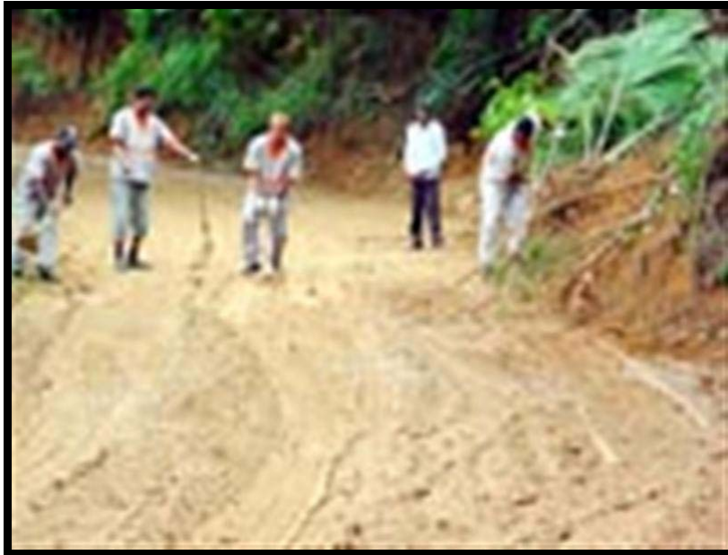
Foto 51: Desobstrução da estrada que foi interditada pelo deslizamento de terras causado pelas chuvas em Rio Preto no mês de dezembro de 2004(Fonte: Jornal "Monitor Campista").
