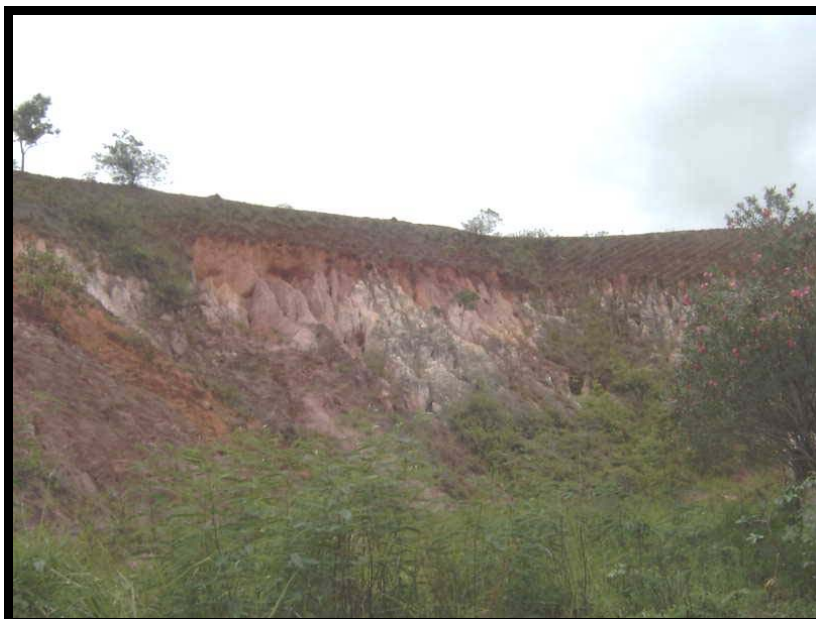
Foto 65: Corte próximo à BR 101, na localidade de Ibitioca. Processo erosivo em solo residual.
