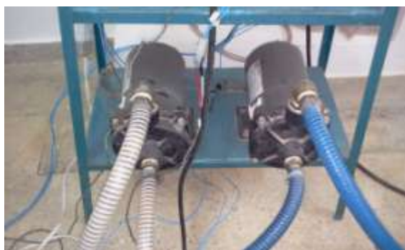
Figura 4.15: Bombas d'água do sistema de enchimento e esvaziamento.
