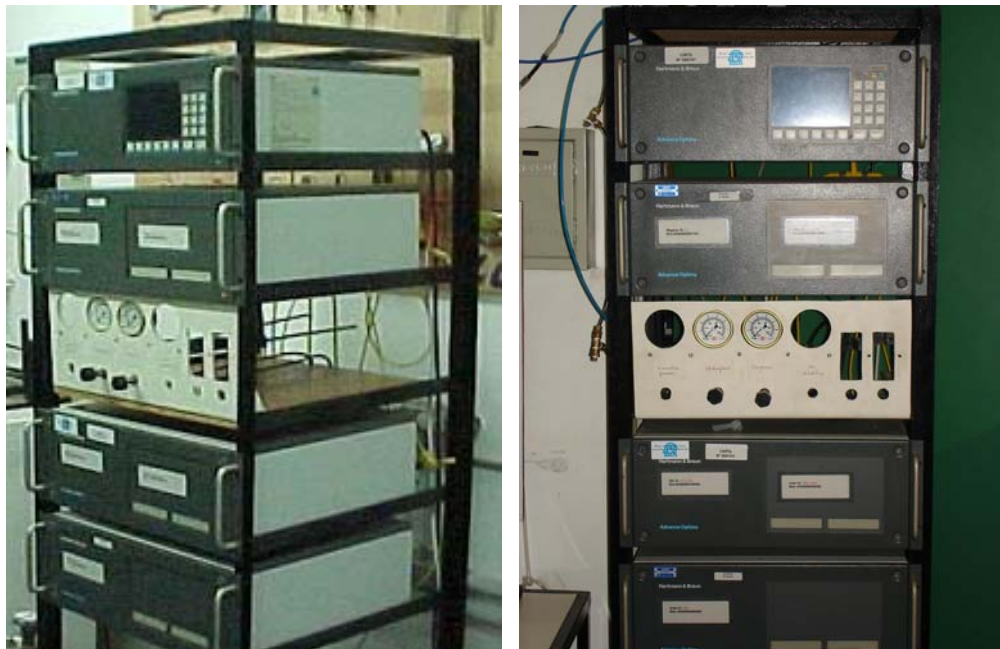
Figura 4.3 – Equipamentos montados para ensaio.
