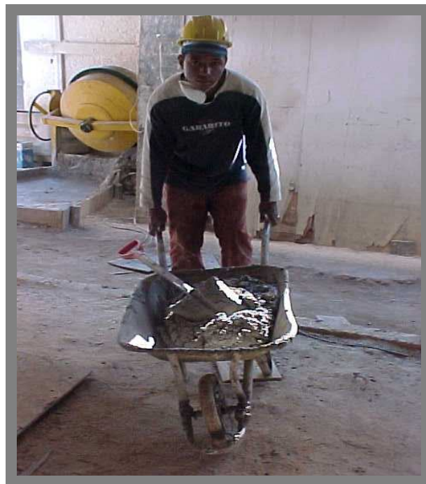
Figura 10 – Transporte de argamassa no carrinho de mão em locais desnivelados (obra C)
