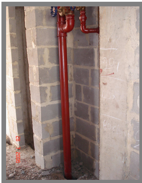
Figura 30 – Utilização de shafts para passagem de instalações - obra C
