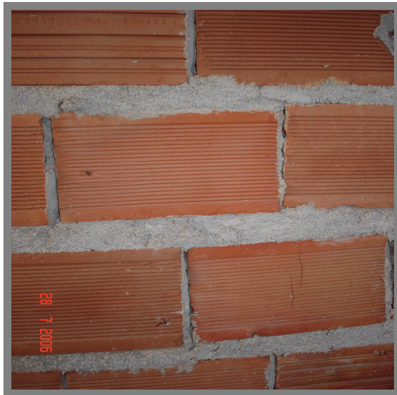
Figura 19 – Sobreconsumo de argamassa nas larguras das juntas horizontais - obra E
