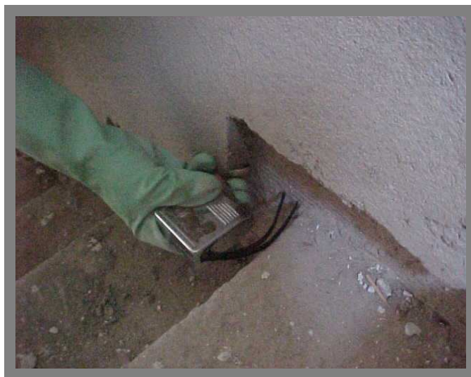
Figura 25 – Largura excessiva do revestimento - obra B
