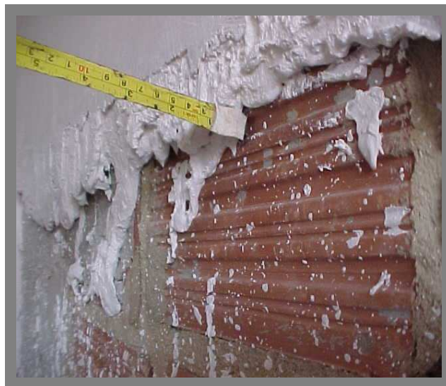
Figura 33 – Sobrespessura de argamassa de gesso - obra B
