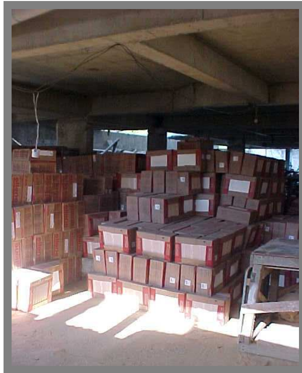
Figura 34 – Armazenamento inadequado das caixas de cerâmicas na obra B
