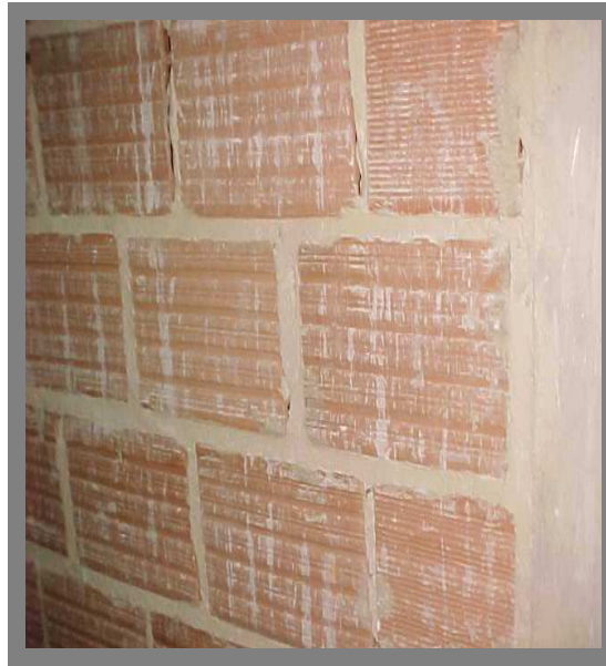
Figura 20 – Sobreconsumo de argamassa nas larguras das juntas verticais - obra B
