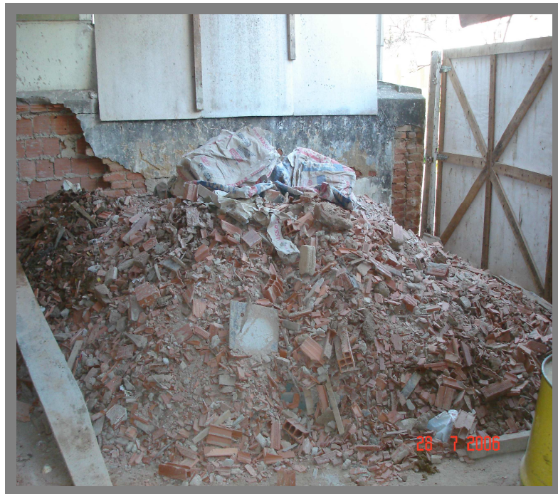
Figura 16 – Rejeitos de blocos cerâmicos e argamassas - obra C
