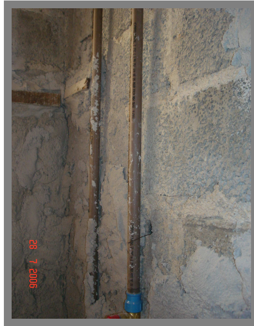
Figura 23 – Sobrespessura no revestimento - obra E
