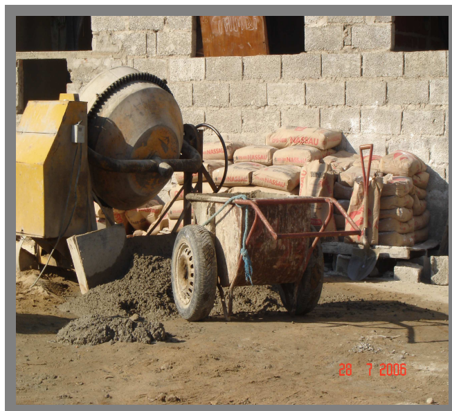
Figura 7 – Estocagem dos sacos de cimento ao ar livre na obra E Como já foi citado anteriormente, os sacos de cimento e cal das obras A, B, C e
