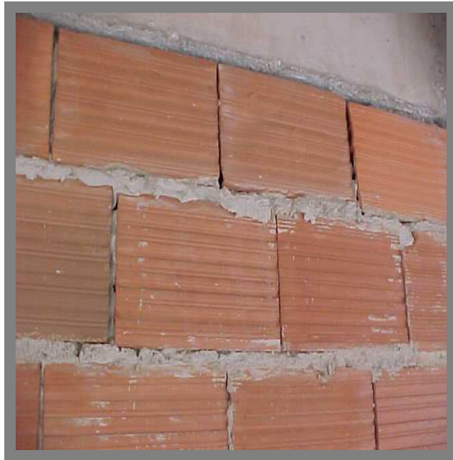
Figura 24 – Diferença da largura da viga e da alvenaria - obra D
