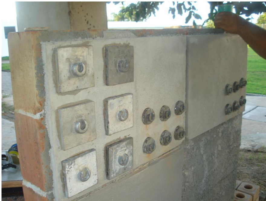
Figura 3.11 - Pastilhas coladas e preparadas para o arrancamento da argamassa.
