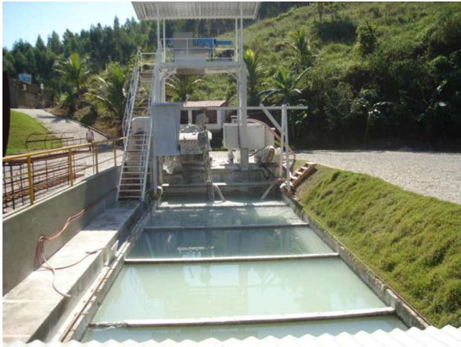
(e) Tratamento do resíduo (poço de decantação).
