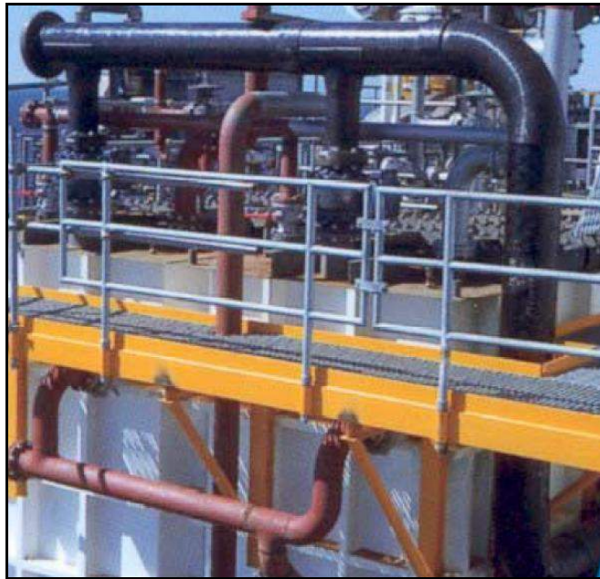
Figura 7 – Tubulação de PRFV em plataforma offshore (Ameron International, 2006).
