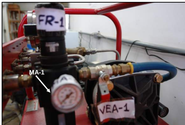
Figura 107 – Detalhe do filtro regulador de ar comprimido (FR-1), válvula de bloqueio de ar (VEA-1) e manômetro de ar comprimido (MA-1).
