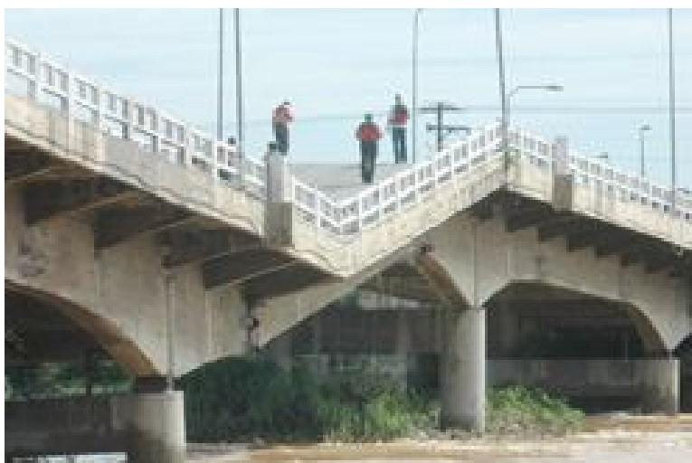
Figura 1 - Ponte General Dutra danificada. Campos dos Goytacazes, RJ. (fonte: www.campos.rj.gov.br )
