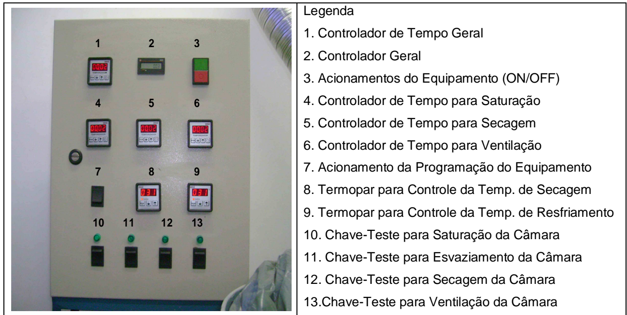
Figura 3.16 – Painel de Controle da Câmara de Degradação.
