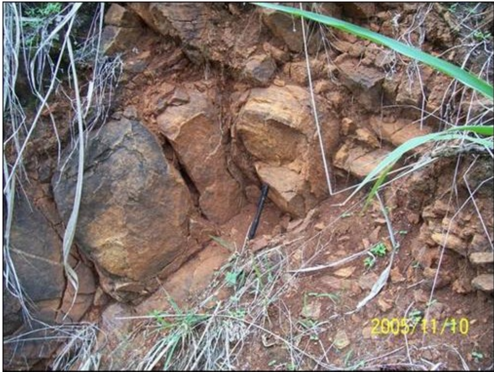
Figura 39: Foto de bloco com perigo de deslocamento
