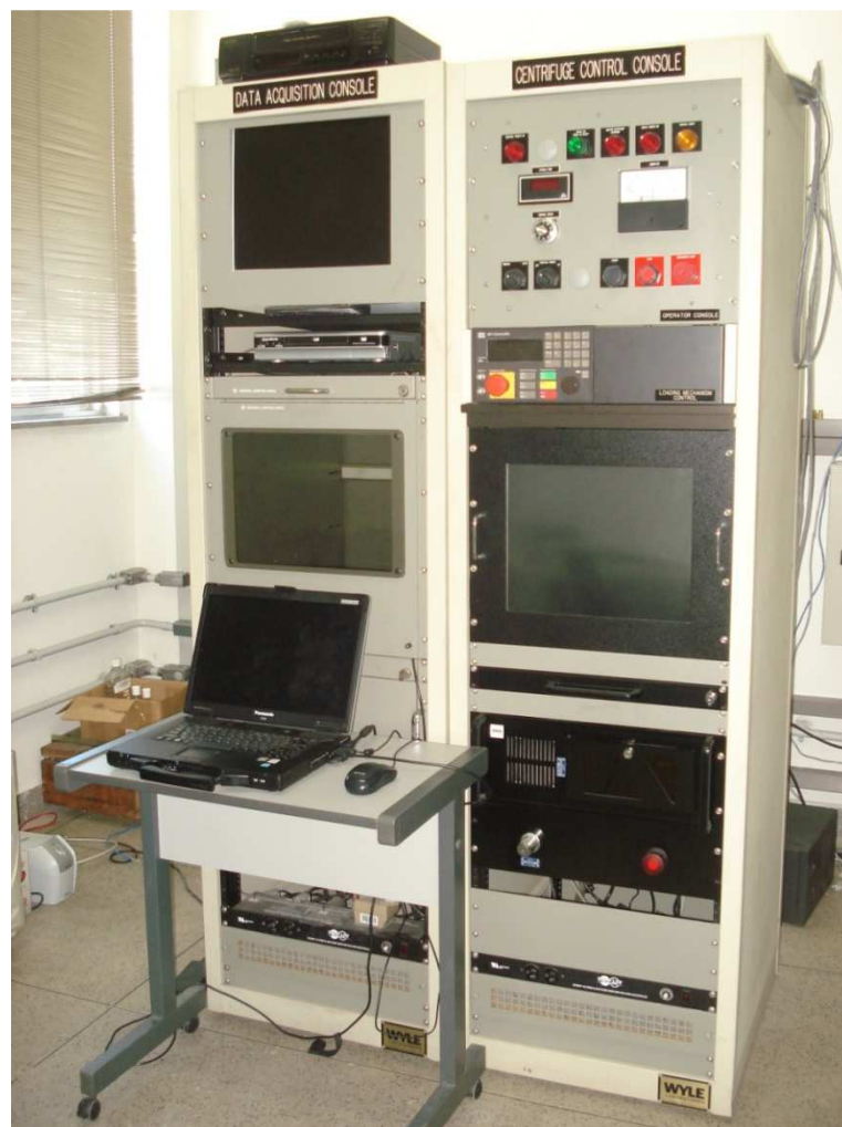
Figura 3.26. Vista da sala de controle da centrífuga
