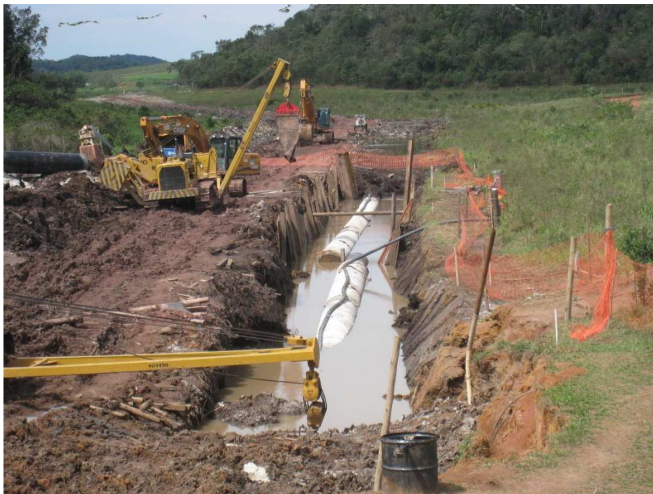
Figura 1.2. Nível do lençol d'água elevado, BR101
