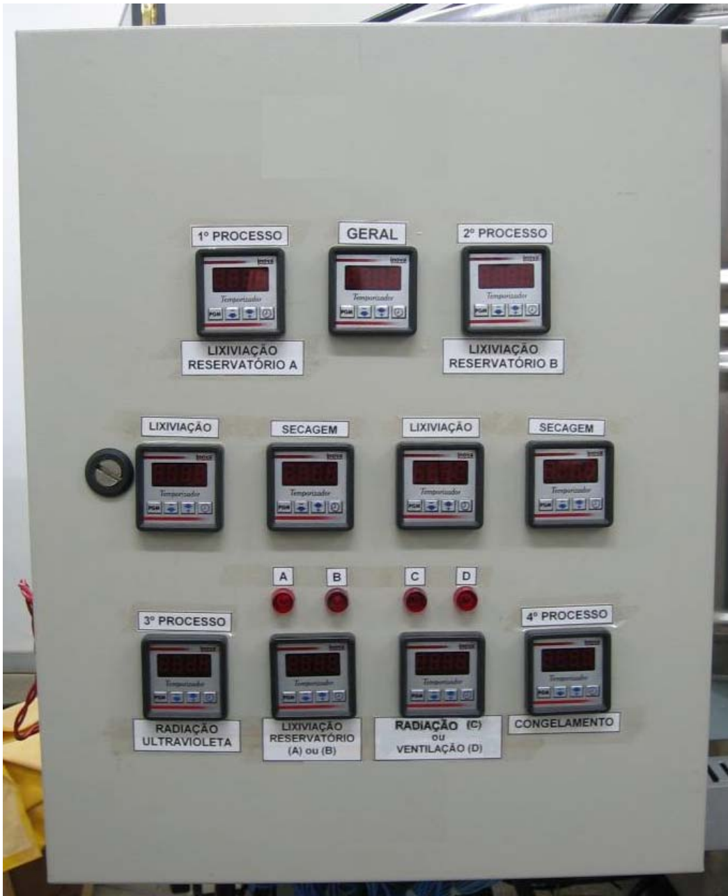
Figura 3.7. Painel dos controladores do equipamento de degradação.
