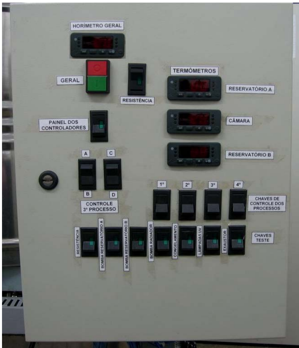
Figura 3.8. Painel de comandos do equipamento de degradação.
