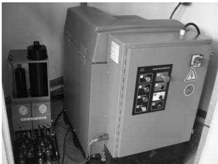
Figura 5.36 – Sistema hidráulico – bomba hidráulica e manifold
