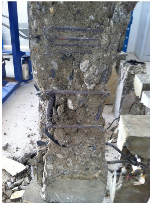
Figura 4.26– Padrão de ruptura final do pilar P1-60-5,0-70.
