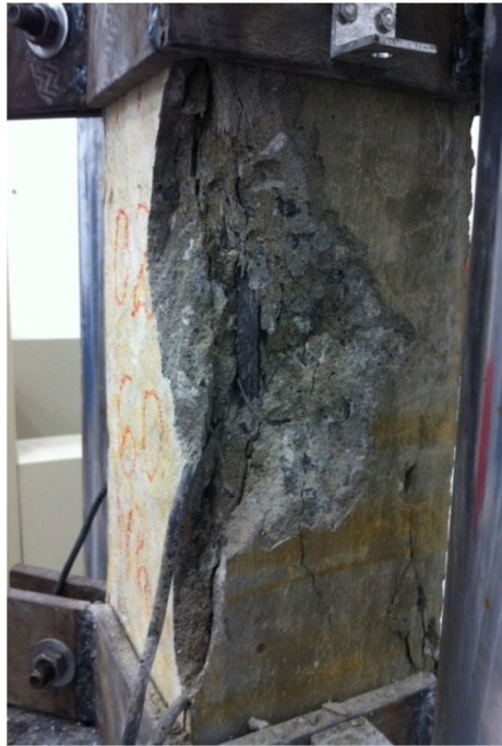
Figura 4.32– Padrão de ruptura final do pilar P1-60-4,2-100.
