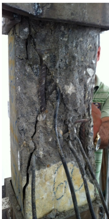
Figura 4.75–Padrão de ruptura do pilar P2-60-5,0-120.
