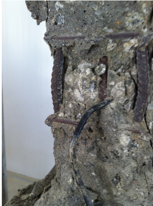
Figura 4.67– Padrão de ruptura do pilar P2-60-5,0-100.
