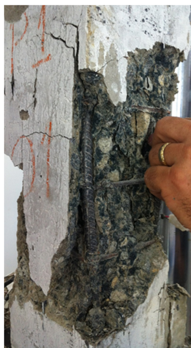
Figura 4.8– Modo de ruptura do Pilar P1-30-4,2-70.
