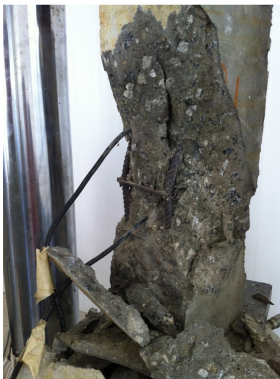
Figura 4.24– Padrão de ruptura final do pilar P1-60-4,2-70.
