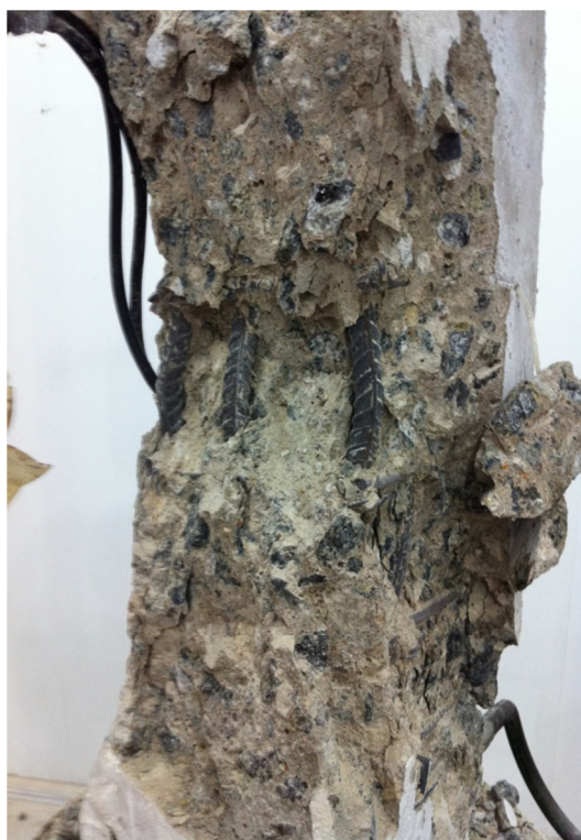
Figura 4.58– Padrão de ruptura do pilar P2-30-5,0-70.
