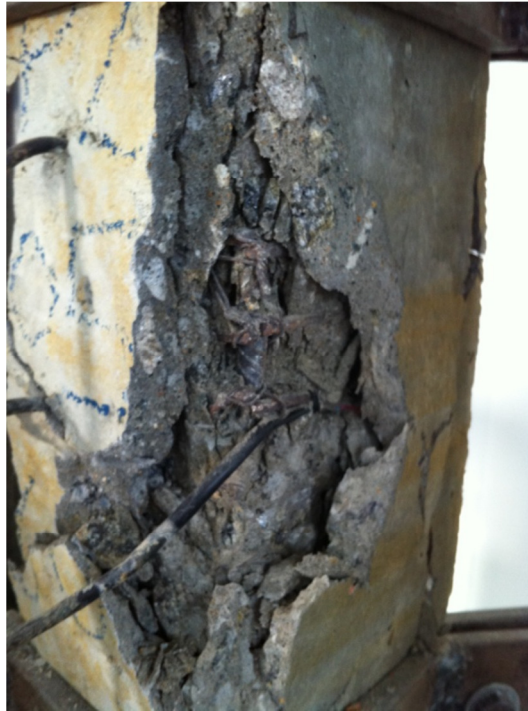
Figura 4.51– Padrão de ruptura do pilar P2-60-5,0-30.
