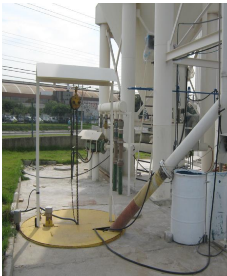
Figura 0.6 - Reservatório onde a água proveniente do processo de lapidação é armazenada antes do tratamento (Viminas, 2013).
