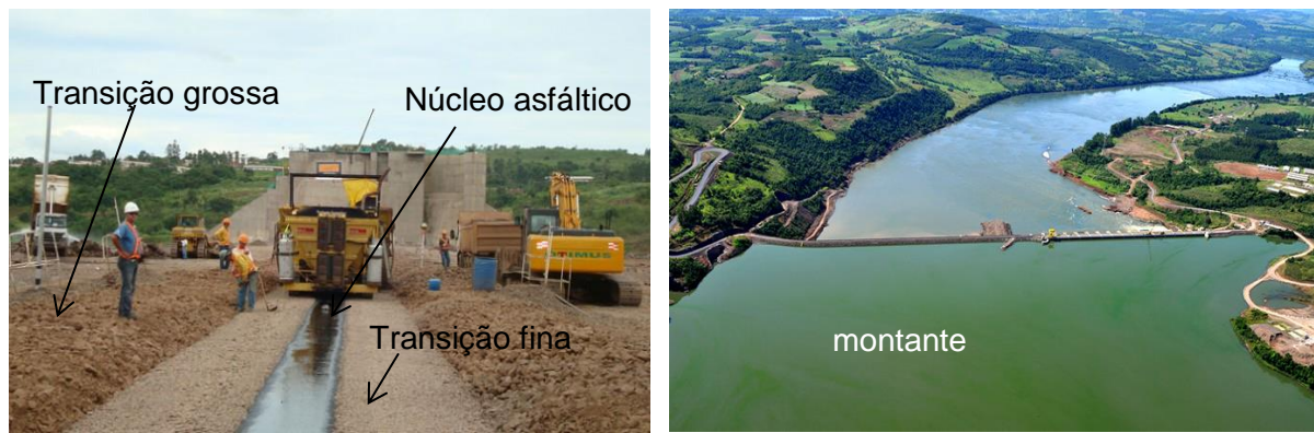
(a) (b) Figura 3.19 – (a) execução de núcleo asfáltico e transição (b) Estrutura de fechamento da calha do Rio Uruguai. (Fonte:www.fozdochapeco.com.br/banco de imagens, acesso em 14/05/2016).
