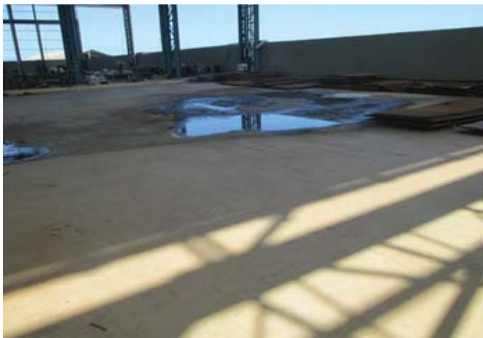
Figura 17-Abaulamento no centro das lajes do galpão, causado por recalques diferenciais.
