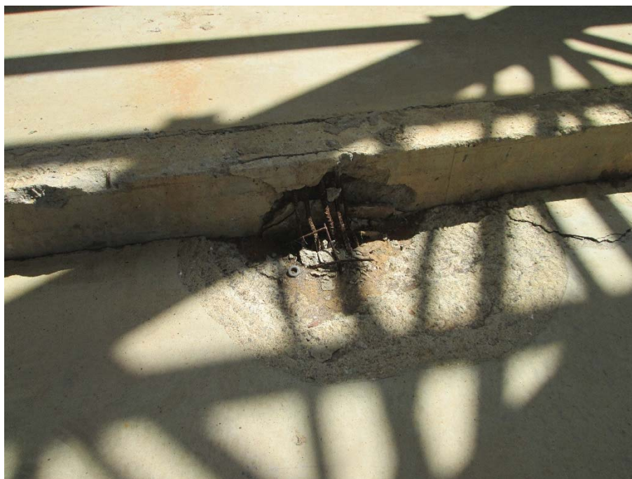
Figura 16 - Ruptura de elementos de ligação entre as lajes internas e os blocos de fundação dos pilares da estrutura metálica, causado por adoção de sistemas de fundações diferentes.
