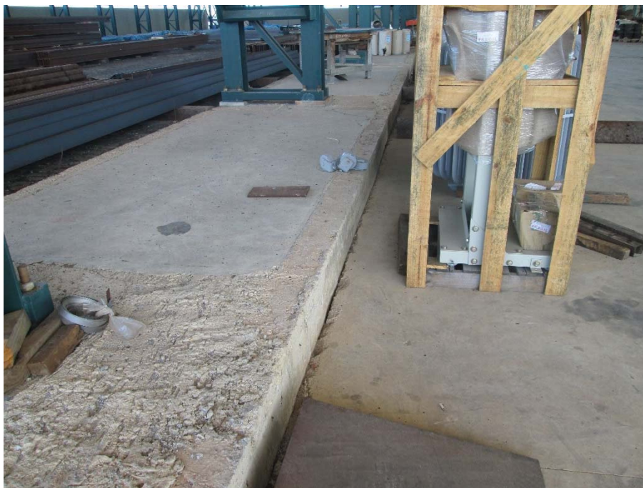
Figura 15 – Desnível acentuado entre as lajes internas e os blocos de fundação dos pilares de estrutura metálica, devido adoção de sistemas de fundações diferentes.
