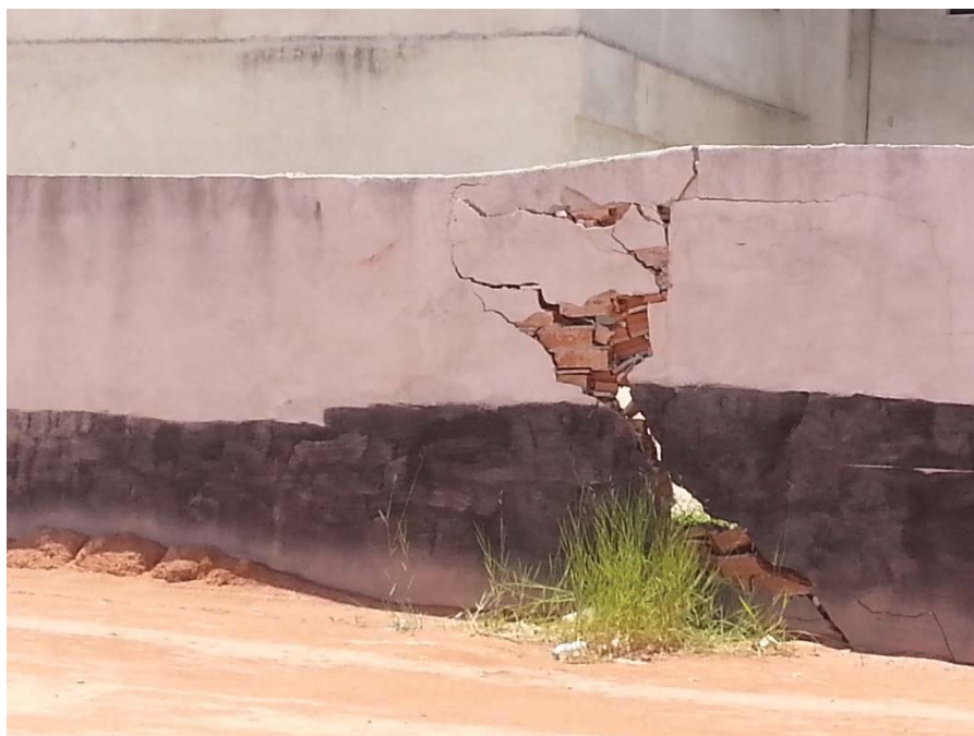
Figura 18- Ruptura da parede externa.
