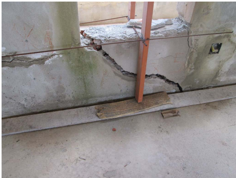
Figura 20 -Ruptura da viga, consequência de adoção de mesmos sistemas de fundações, porém com diferentes rigidezes.
