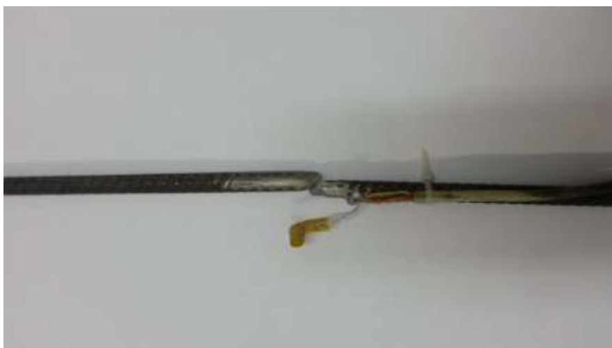
Figura 19 - Armadura de 8 mm após ruptura
