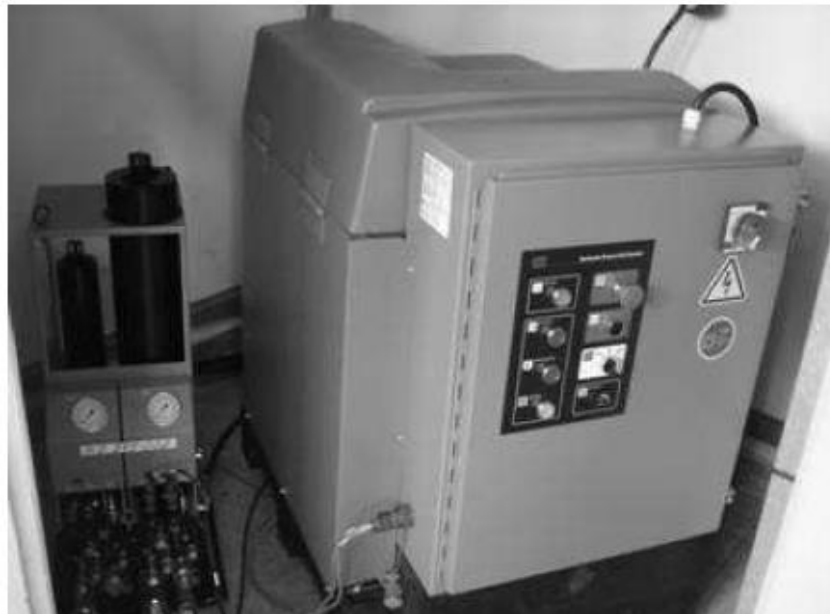
Figura 3.11 – Sistema hidráulico – bomba hidráulica e manifold (Brum Junior, 2009).
