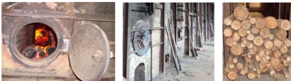
Figura 3-19: Detalhes da fornalha: portas de alimentação e lenha de eucalipto
