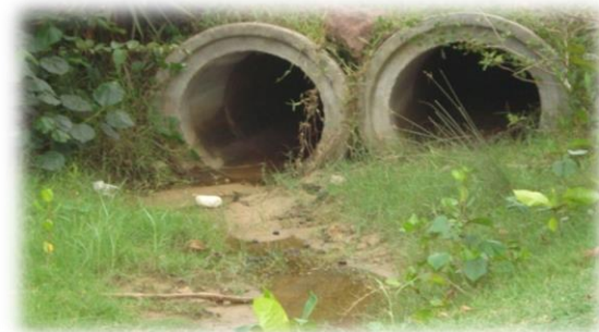
Figura 6.42. Esgoto à céu aberto.
