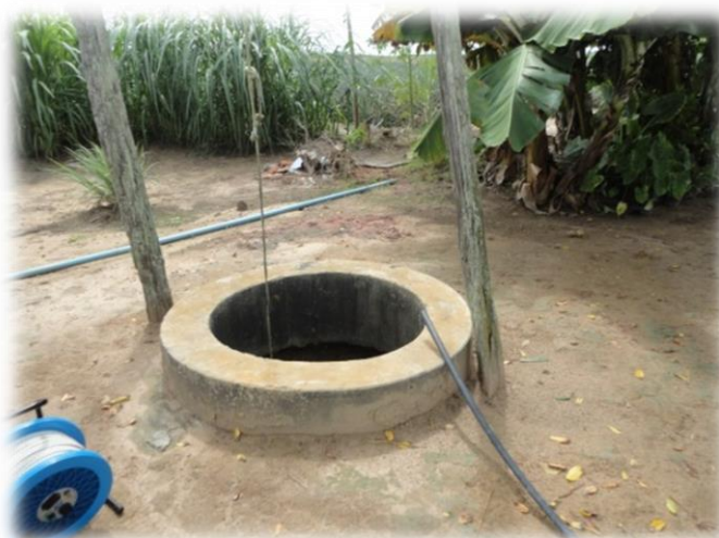
Figura 6.3. Poço raso sem tampa de proteção e sem revestimento interno.
