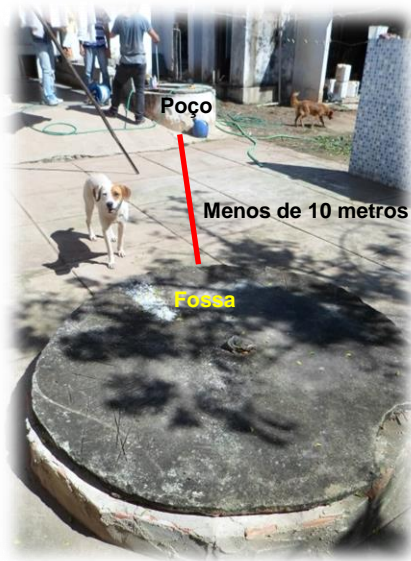
Figura 6.37. Poço sem distância mínima entre a Fossa.
