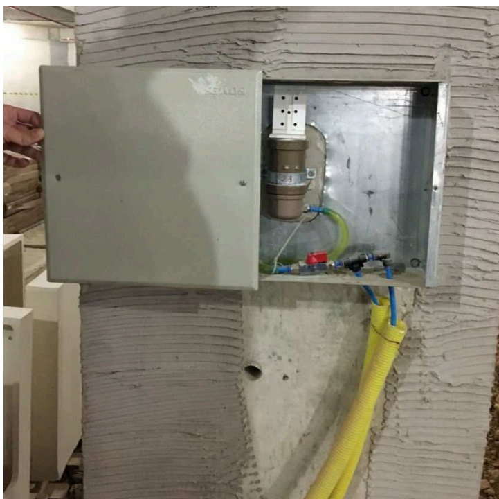
Figura 27 – Sistema de monitoramento de recalque baseado no princípio de vasos comunicantes.
