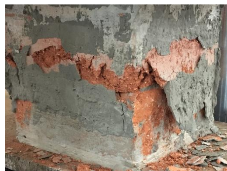
Figura G.4 – Bloco 4 rompido
