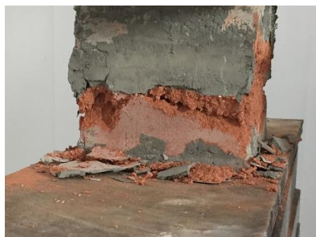
Figura G.5 – Bloco 5 rompido
