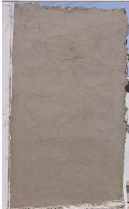
Figura 2.18 – Fissuração apresentada em argamassa com saibro, imediatamente após aplicação.
