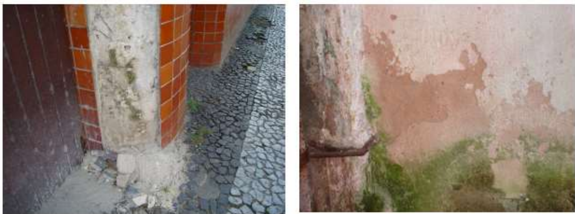
Figura 2.19 – Desagregação da argamassa com saibro.
