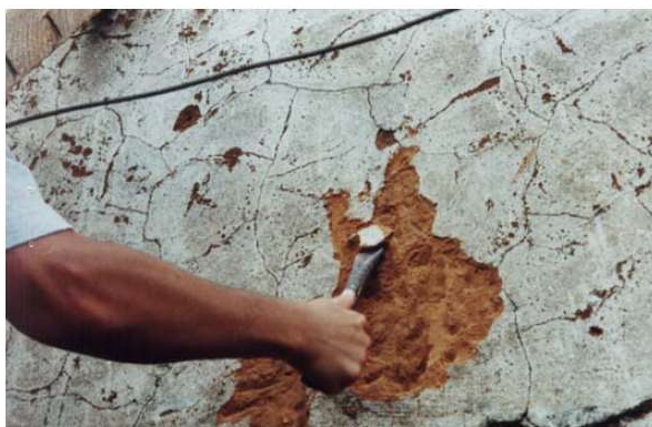
Figura 2.17 – Patologia de revestimento com argila.
