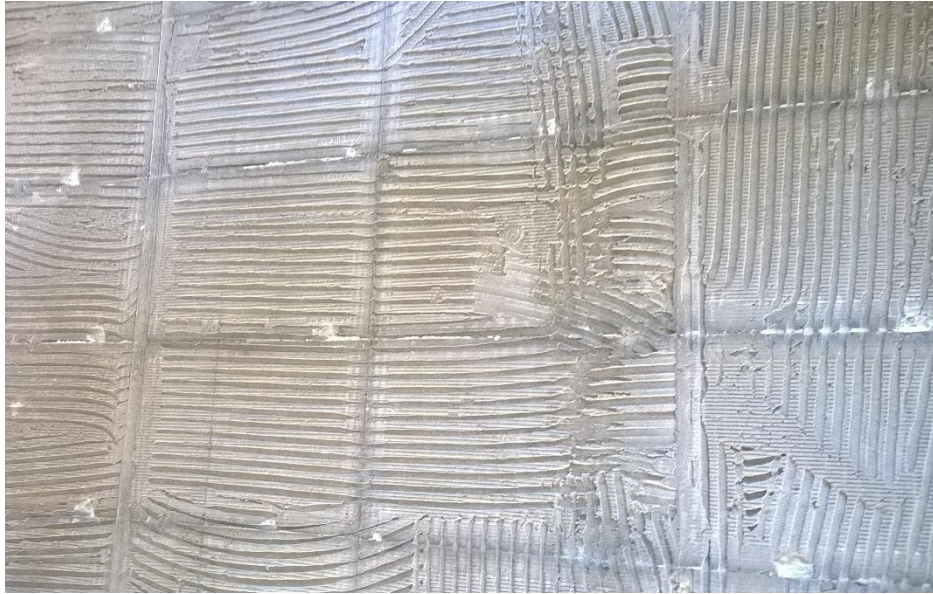
Figura 9 - Aparência em campo da patologia estudada.
