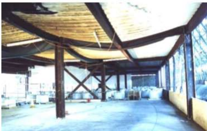
Figura 1.5: Vista geral de um dos pavimentos do Edifício Cardington após o incêndio (LAMONT, 2001).
