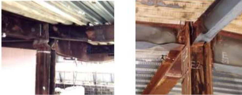
Figura 1.6: Configuração deformada dos elementos estruturais após o incêndio (LAMONT, 2001).
