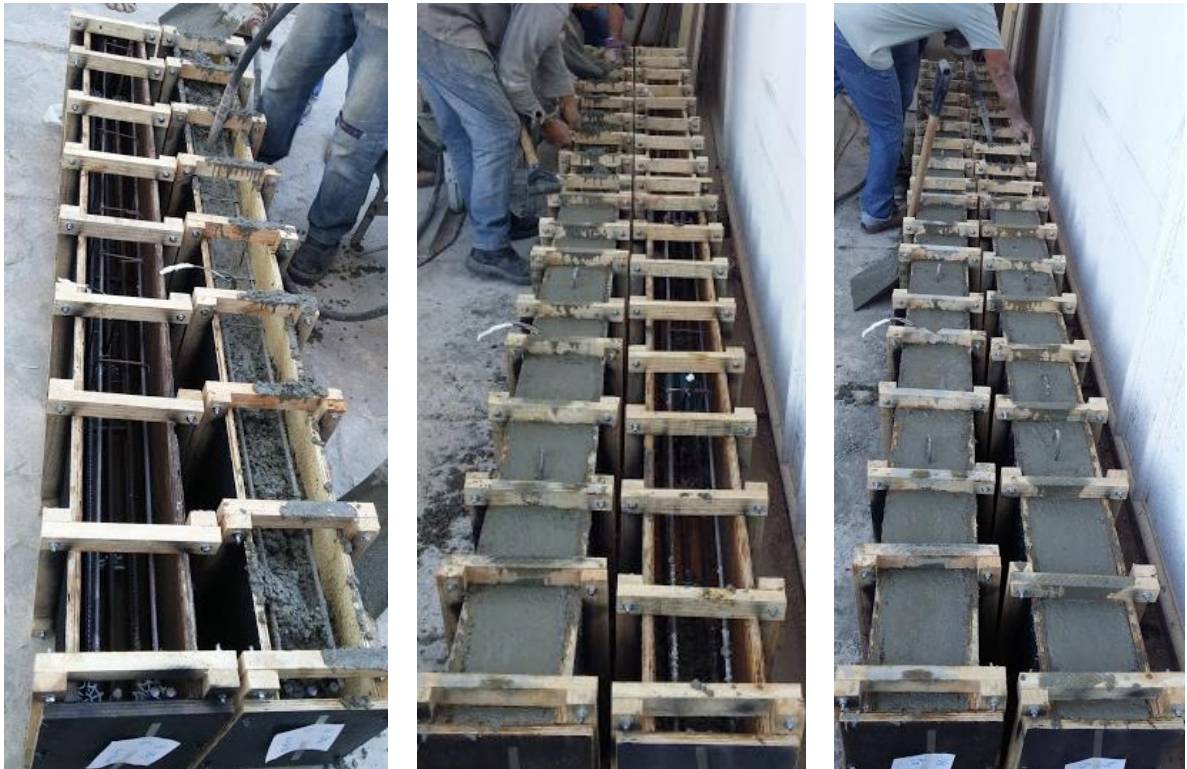
Figura 3.42 – Concretagem das vigas de CCR e CLE, utilização de vibrador de imersão para adensamento mecânico.
