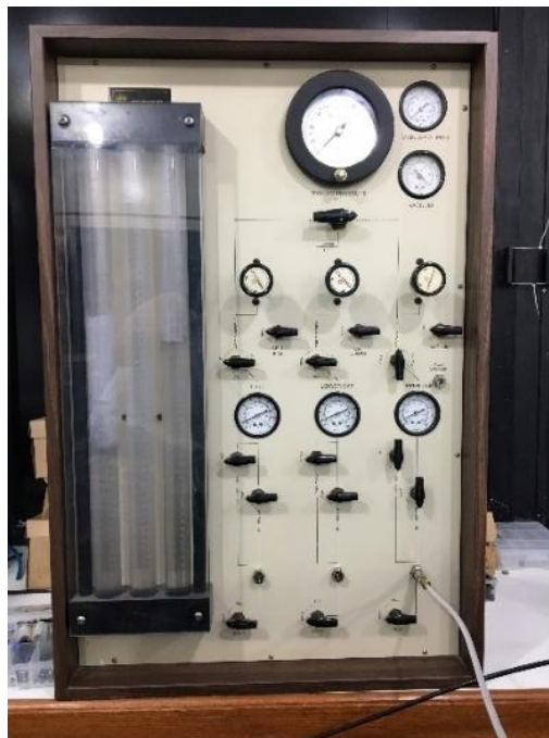
Figura 3.26. Painel de controle hidráulico – pneumático.
