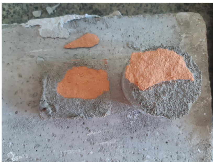
Figura 58 – Ruptura parcial entre a argamassa e o bloco cerâmico chapiscado.
