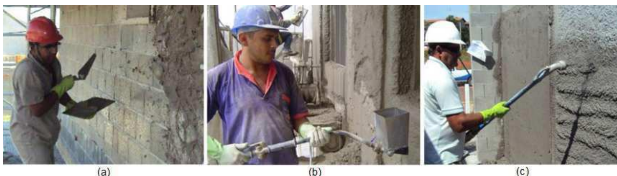
Figura 10 - Aplicação de revestimento de argamassa: (a) método de lançamento manual; (b) aplicação por spray; (c) aplicação por projeção mecânica contínua.
