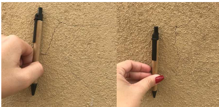
Figura 22 - Caneta com 13,5 cm de comprimento ao lado das fissuras no estado endurecido.
