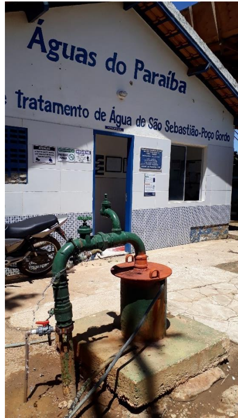
(b) Poço São Sebastião - Águas do Paraíba
