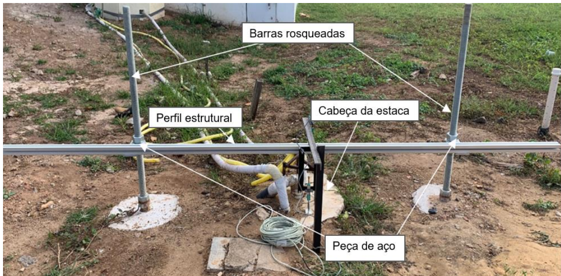
Figura 29 - Disposição dos equipamentos in loco.
