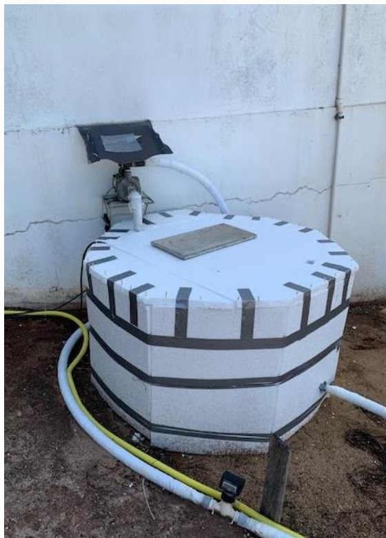
Figura 33 - Tanque isolado termicamente.
