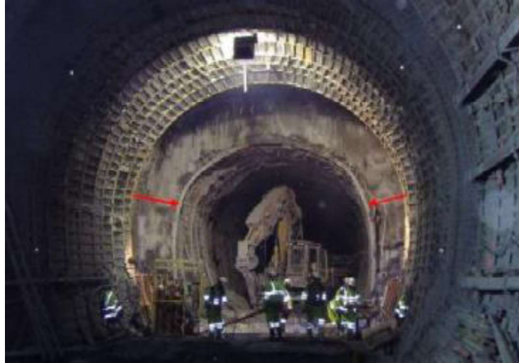
Figura 3 - Ocorrência de squeezing na construção do túnel para a ligação de alta velocidade entre Lyon e Turim. (Melâneo, 2011).
