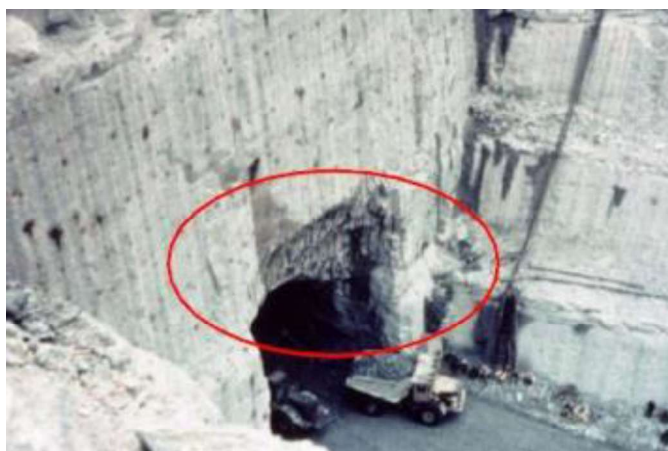
Figura 5 - Colapso do emboquilhamento (Seidenfuss, 2006).
