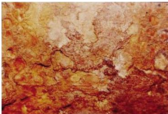
Figura 16: Corrosão uniforme em chapa de aço carbono.
