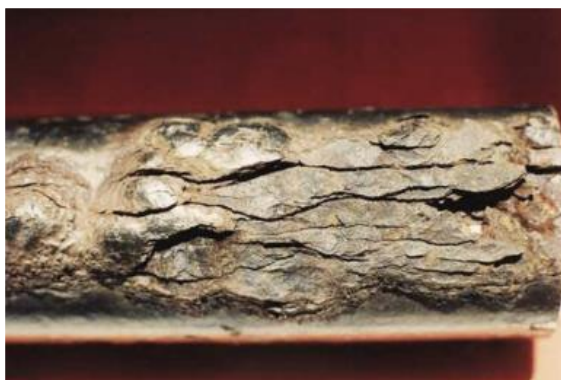
Figura 28: Corrosão por esfoliação.
