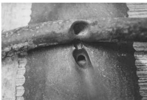
Figura 19: Pites no tubo de água galvanizado que contribuíram para a erosão da linha de gás e ao vazamento subsequente em um cano de gasolina que causou a explosão de Guadalajara 1992.
