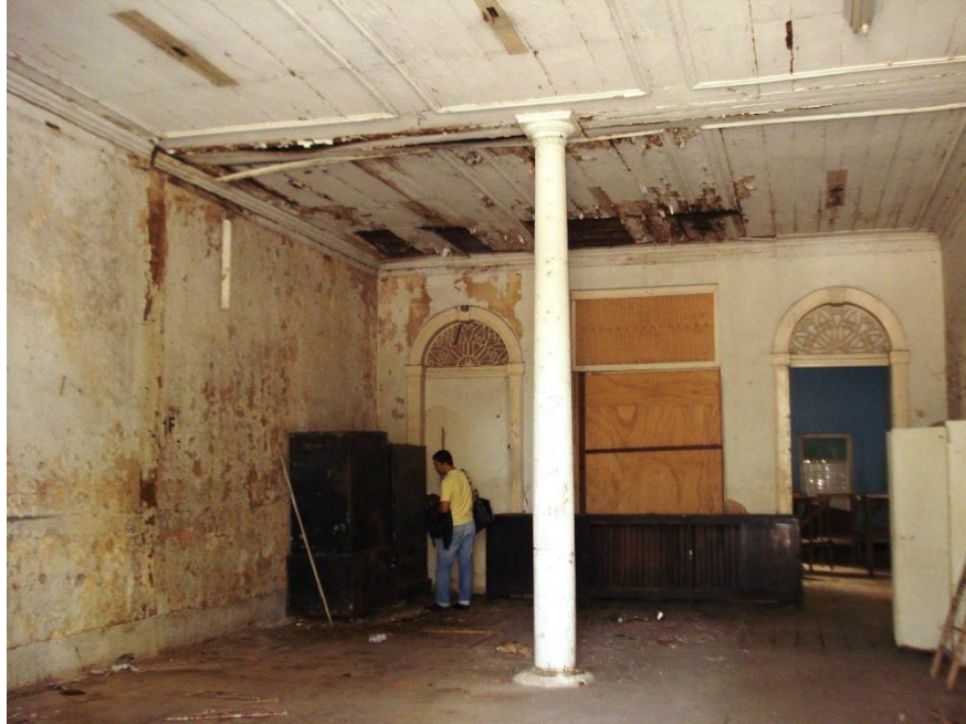
Foto 2 – Espaço interno do Solar Visconde de Araruama antes do início da restauração
