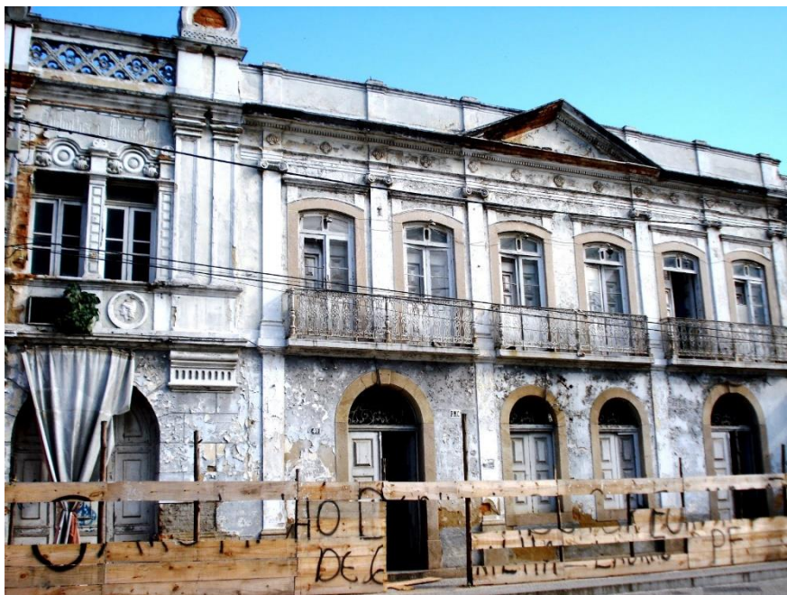
Foto 1 – Solar Visconde de Araruama antes do início da restauração
