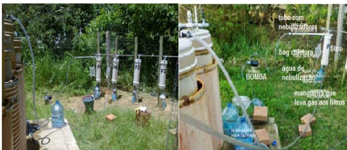
Figura 22 – Instalação dos filtros com coleta de biogás, destacando o filtro à água.
