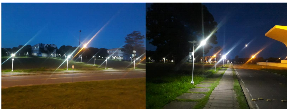
Figura 6 – Imagens mostrando a iluminação com postes de energia fotovoltaica no Campus Leonel Brizola da UENF em Campos dos Goytacazes, RJ
