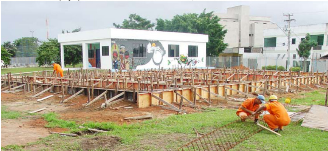
Obra de espaço para atividades extracurriculares, tendo ao fundo o novo DCE
